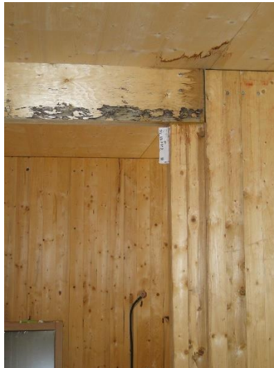
Figure 6 – Suite à des infiltrations d'eau, des traces d'efflorescences restent visible à la jonction plafond - linteau – poteau (Source AQC [34])
