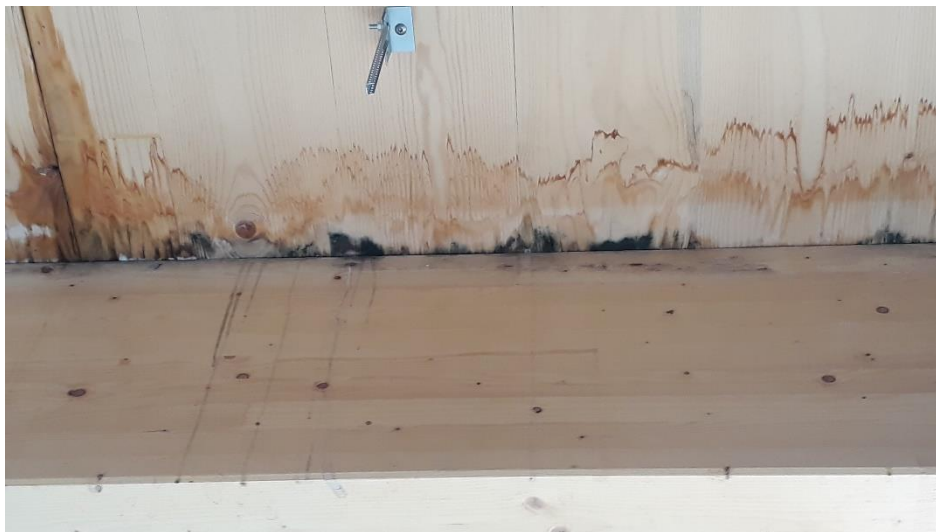
Figure 5 – Exemple de bleuissement à la jonction plancher CLT/Poutre suite à une humidité excessive en phase chantier
